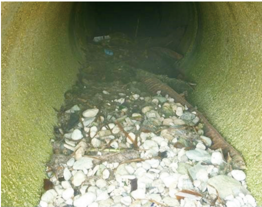
FIGURA 5. Descarga de colector pluvial al mar tapado con basura y materiales pétreos
